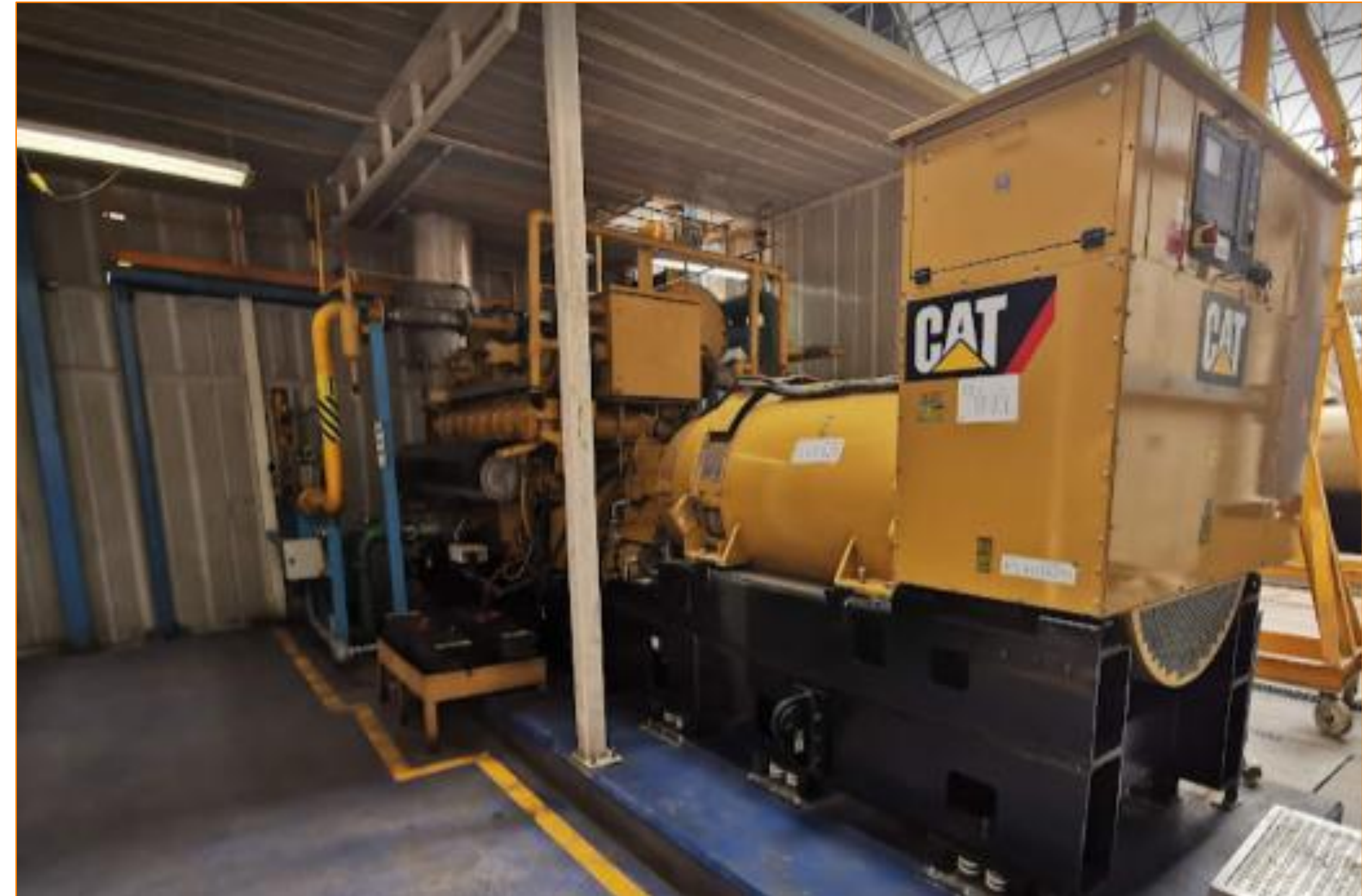
SALA DE GENERACIÓN
